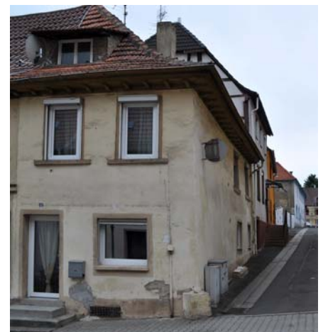
Abb. 29 Gebäude mit erheblichen baulichen Mängeln in der Amtsstraße
